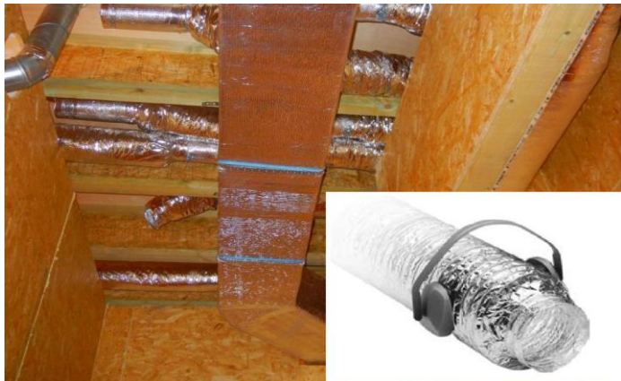
Пример разводки в доме гибких воздуховодов
